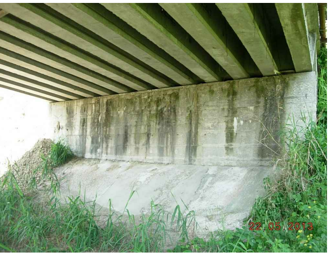
Foto 9: infiltrazioni spalla sx
