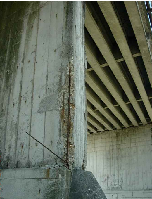
Foto 10: cls ammalorato e armature ossidate base pila dx lato nord
