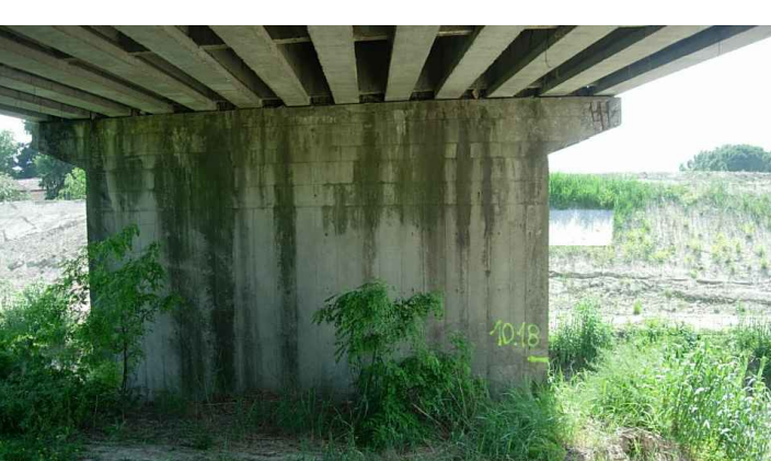
Foto 8: infiltrazioni pila sx
