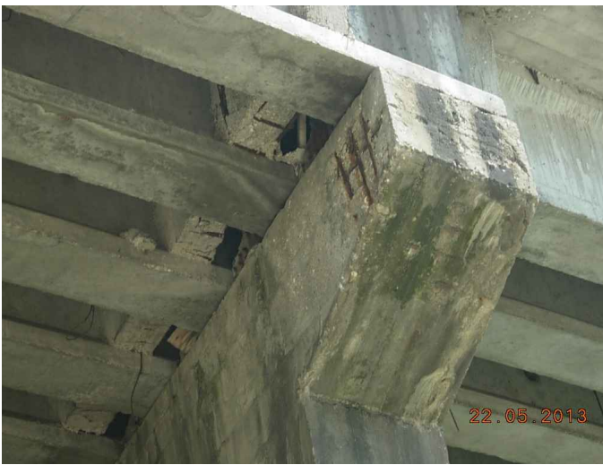
Foto 7: cls ammalorato e armature ossidate pulvino pila sx - lato sud
