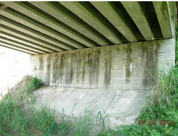
Foto 11: infiltrazioni spalla dx
